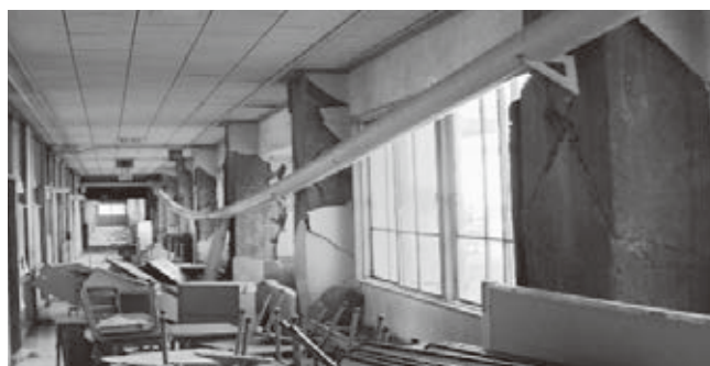
被災した須賀川市立第一小学校
